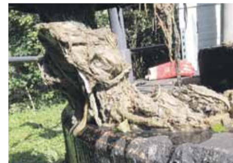
Tak kończy się wrzucanie do kanalizacji nieodpowiednich substancji i artykułów
