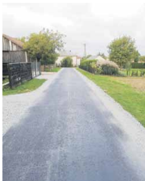
Drogi w Rogóźnie już gotowe. Pozostałe są w trakcie realizacji FOT. UG ŁAŃCUT
