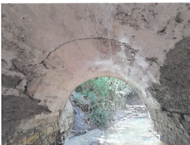
Pęknięcia sklepienia łuku
