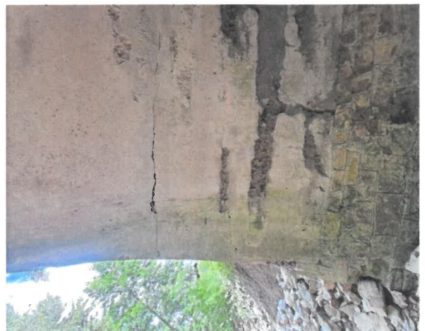
Pęknięcia łuku nośnego
