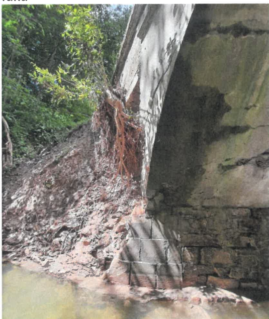
Rozmycie przed mostem strona lewa
