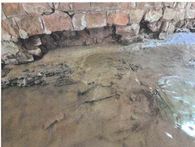
Uszkodzenia kamiennego muru podwalinowego łuku
