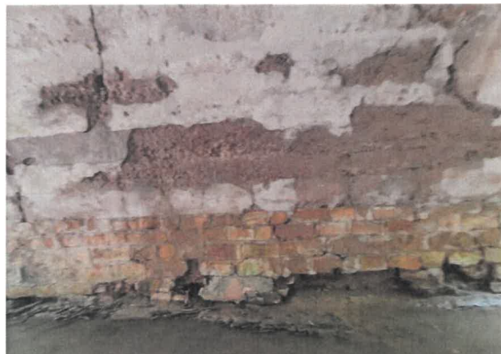
Uszkodzenia kamiennego muru podwalinowego łuku
