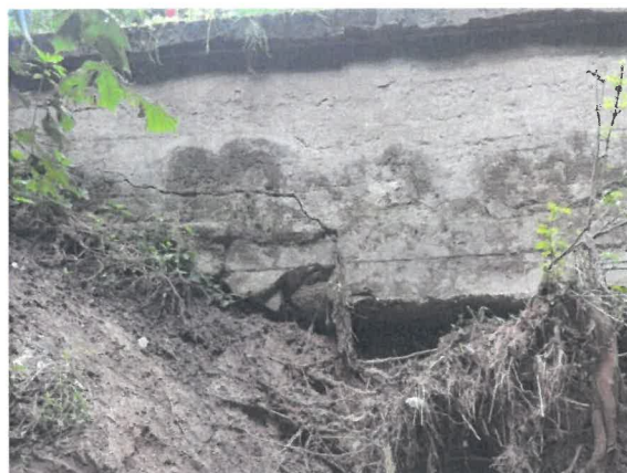
Pęknięcie belki oczepowej
