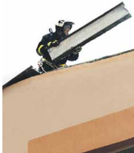
Na dachu Zespołu Szkół w Wysokiej oderwał się fragment blachy FOT. BERNADETA BRÓZ
