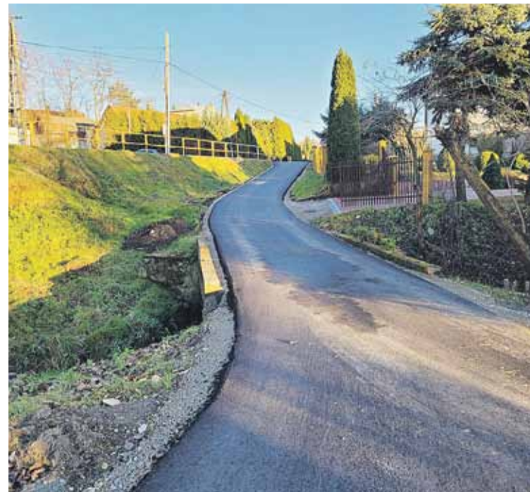
GMINA ŁAŃCUT Ciąg dalszy przebudowy dróg wewnętrznych w gminie Łańcut. Tak wygląda teraz Droga „Za Ośrodkiem Zdrowia” w Kosinie. - 19 listopada otwarliśmy oferty na przebudowę kolejnych dróg wewnętrznych na terenie gminy. Kilka z nich będzie wykonanych jeszcze w tym roku - mówi wójt Jakub Czarnota
